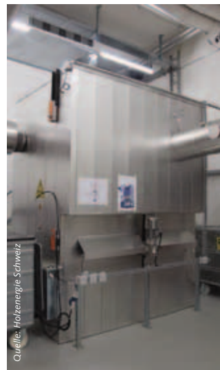
Der Partikelabscheider der Holzschnitzelheizung sorgt für absolut saubere Luft in der Höhenklinik Wald ZH.
