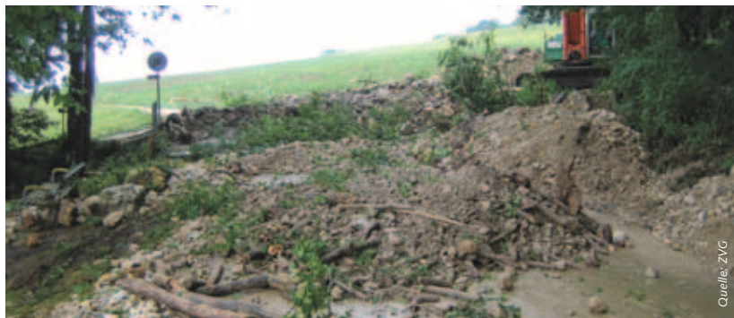
Bettlach, Schäden beim Giglerbach
