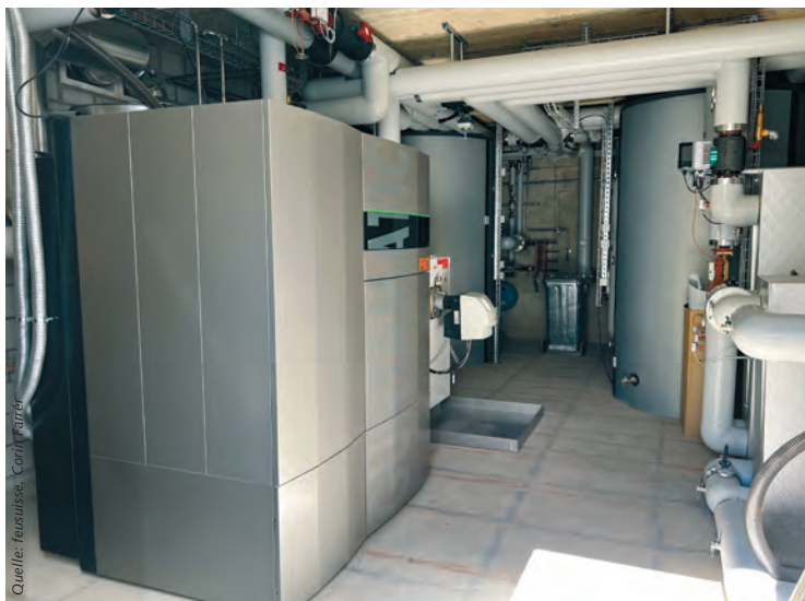
Zukunftstauglich: Neue Heizzentrale des Wärmeverbundes Froburg
