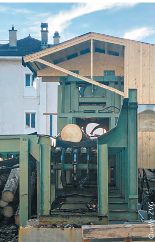
Neue Entrindungsanlage der Firma Dutoit SA Chavornay
